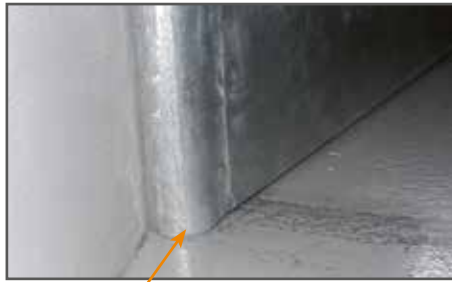
Seitliche Räumklappe Achtung: scharfe Kanten! (-> abrunden!)
