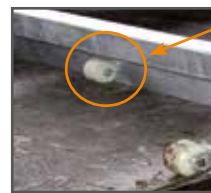
Steuerkufe an Haupträumklappe mit Rolle
