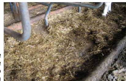
Плохое состояние глубокого бокса
